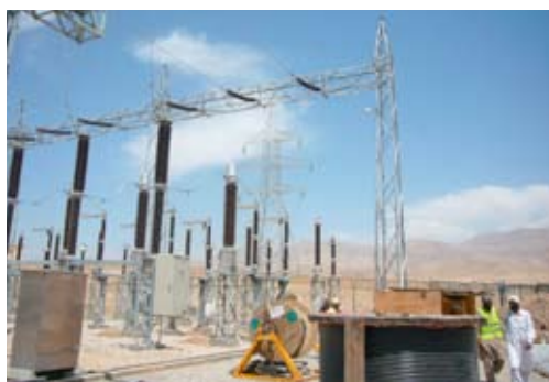
Umspannstation in Mazar-e Sharif. (F: KfW)
